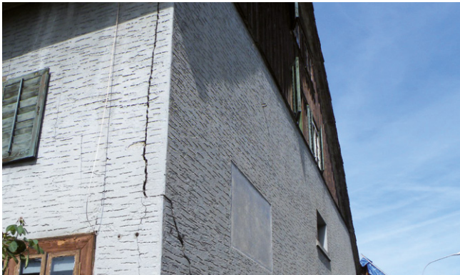
Risse im Bauteil
