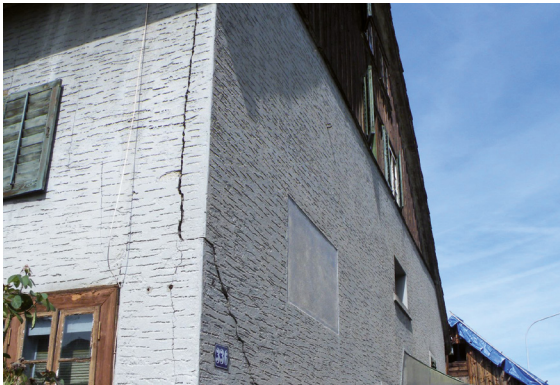
Risse im Bauteil
