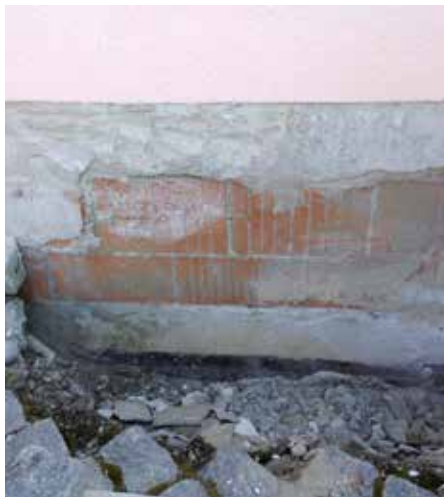
Deteriorarea soclului prin acumulare de apă
