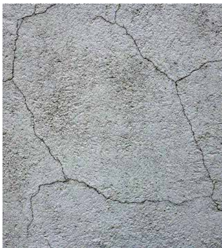
Fisură de contracție
