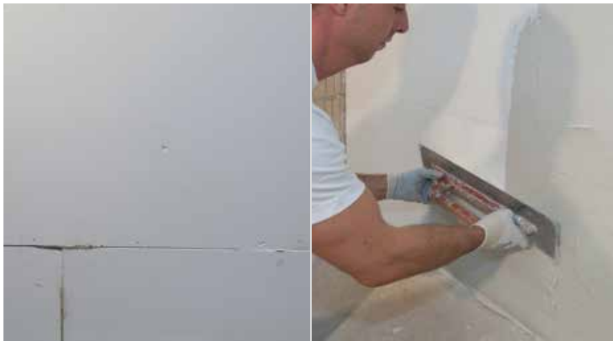
Rosturi îmbinate cap la cap | Armare cu masă de șpaclu adezivă specială RÖFIX Renopor® Spezial-Klebspachtel
