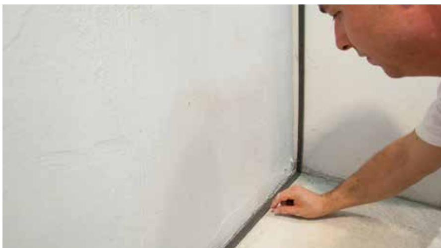
Montaggio di RÖFIX Nastro di guarnizione a giunzioni di parete e soffitto
