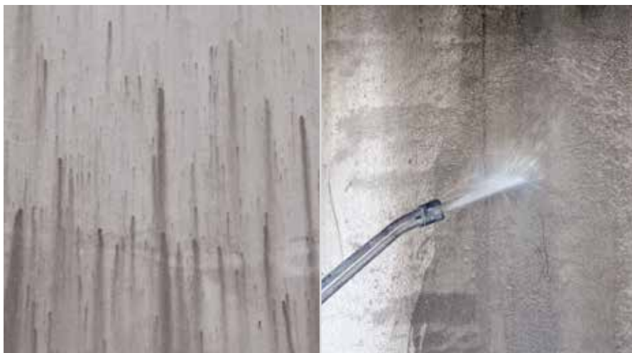
Intonaco di facciata infestata con alghe/funghi
