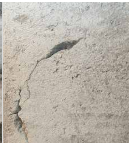
Cavità nell'intonaco vecchio
