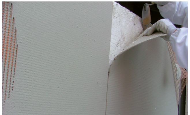
Abschälung der Einbettung von EPS-Platten
