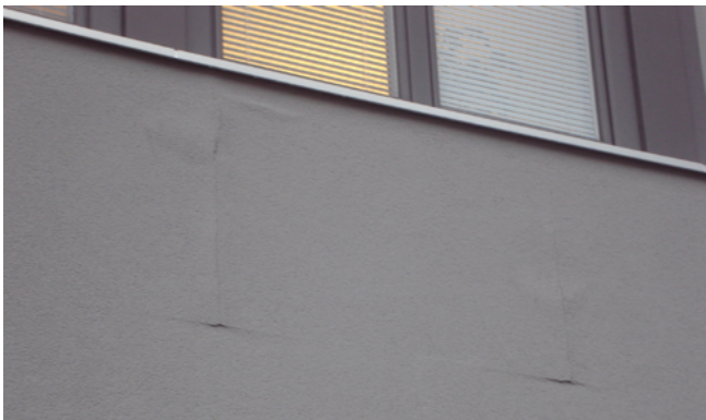
Risse und Putzaufwölbungen im Plattenstoss
