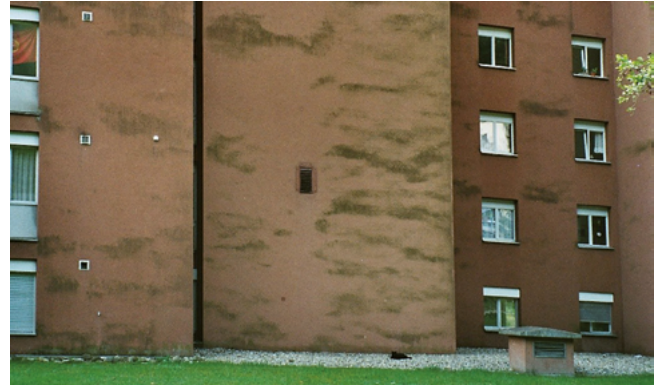
Durchnässte Fassade mit Algenbewuchs
