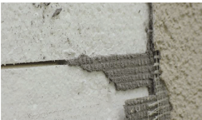
Mörtel im Plattenstoss
