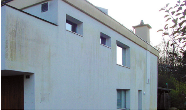
Fassade mit Algenbewuchs
