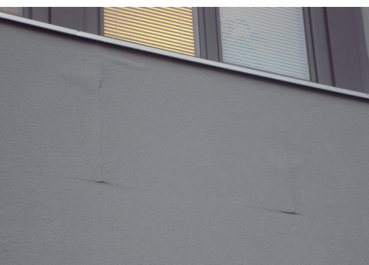
Fessure e rigonfiamenti dell'intonaco di finitura in corrispondenza dei giunti dei pannelli
