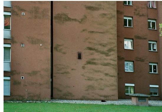
Facciate aggredite dall'umidità con la presenza di alghe
