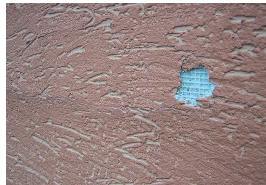
Distacco dell'intonaco di finitura
