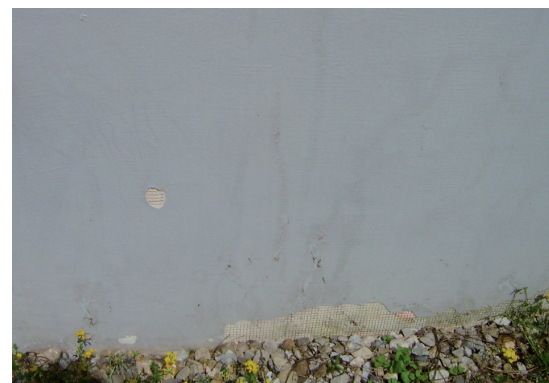
Distacco dell'intonaco di finitura
