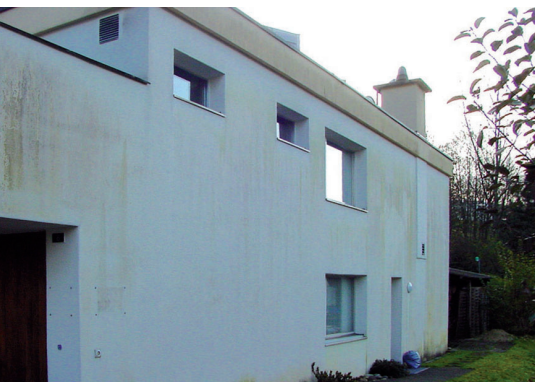
Facciata sporcata da alghe
