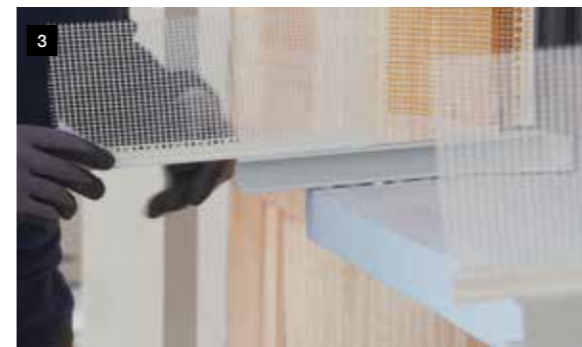
3 SOL-PAD Anputzleiste satt und dicht mit MS-Polymer an das Basisprofil und auf die Abdichtung kleben (SOL-PAD Anputzprofil erst nach Trocknung Armierungsmörtel kürzen)
