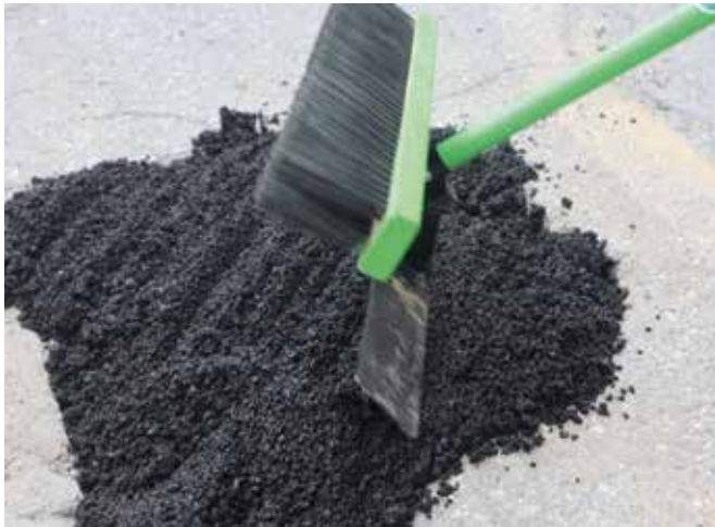
Verteilen des Materials mit Hilfe eines Rechens oder eines Spezialwerkzeugs in homogener und ebener Form, in einer Minstdicke von 2 cm.
