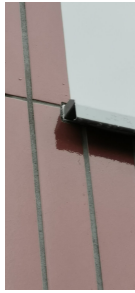
Alubank sauber entkoppelt von Fassade
