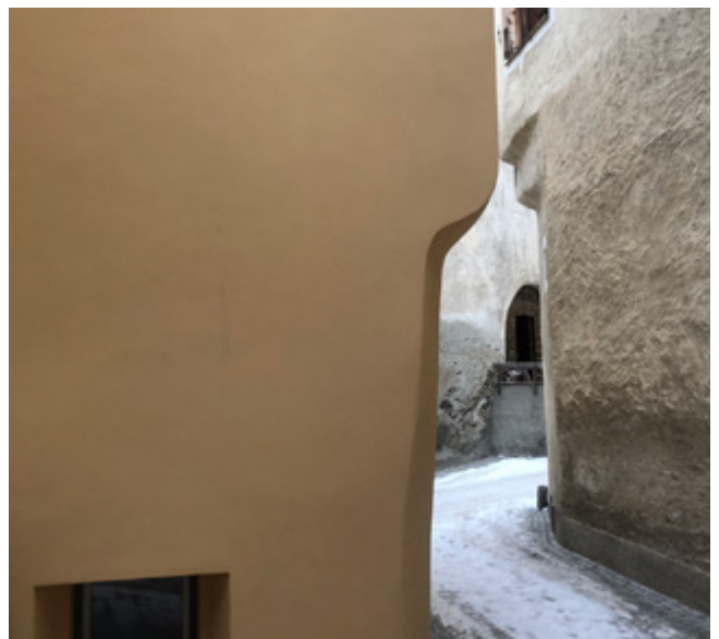
Hier erzählt die Fassade mit Aerogel Hochleistungsdämmputz eine Geschichte, die weiterhin nachvollziehbar ist.
