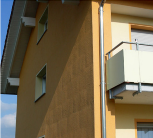
Streiflicht auf der Fassade bei Dämmplatten; die Platten sind sichtbar, müssen aber gemäss SIA 243 «Verputzte Aussenwärmedämmung» akzeptiert werden.
