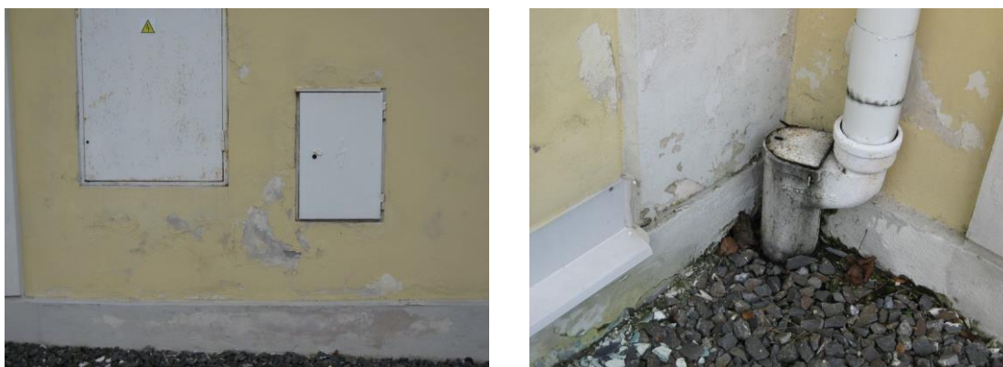
Fotografie 5.14.7 - 5.14.8 : Důsledky použití nevhodného neprodyšného nátěru
