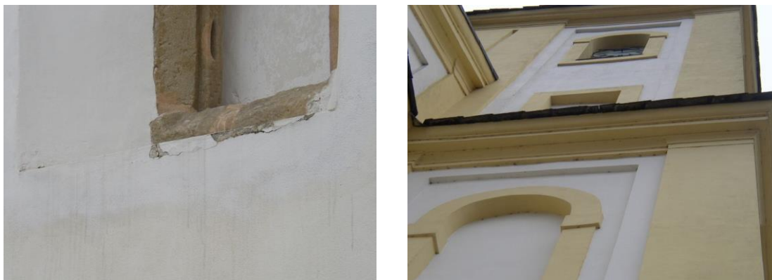
Fotografie 5.6.5 - 5.6.6 : Porucha omítky pod kamenným ostěním výklenku a porucha krytí štukové římsy břidlicí, kde odkapávající voda znehodnocuje omítku.
