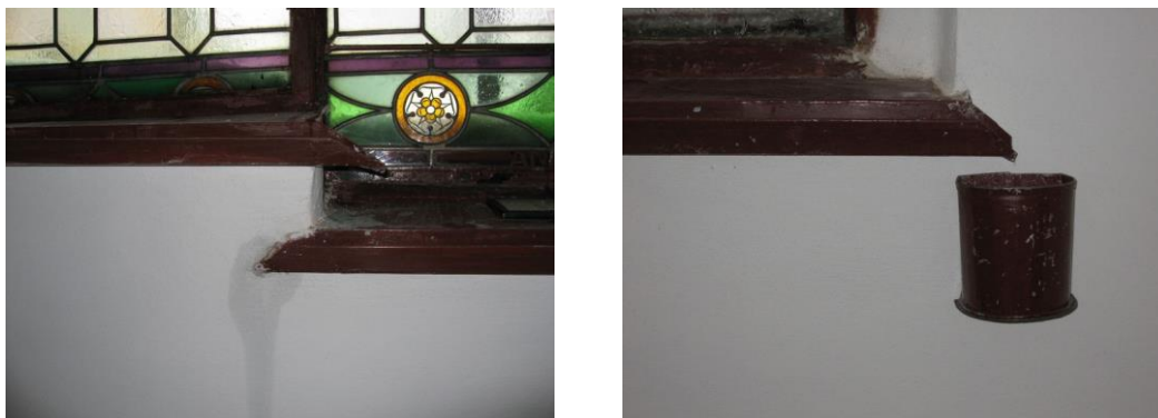
Fotografie 5.5.3 - 5.5.4 : Detaily oplechování parapetů oken na chodbách
