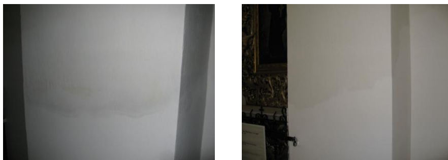
Fotografie 5.5.5 - 5.5.6 : Viditelné rozdíly vlhkosti na stěnách
