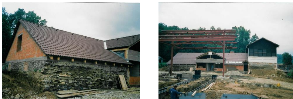
Fotografie 5.13.1 – 5.13.2 : Původní stav objektu před sanací
