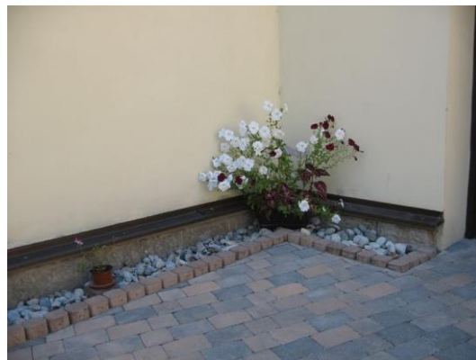
Fotografie 5.2.4 : Odvětrávací systém podél kostela
