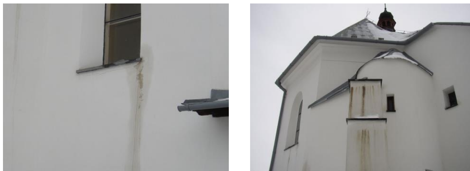
Fotografie 5.4.12 - 5.4.13 : Detail uložení břidlicové parapetní desky a znehodnocení omítek na šikmých stranách opěrných zdí.
