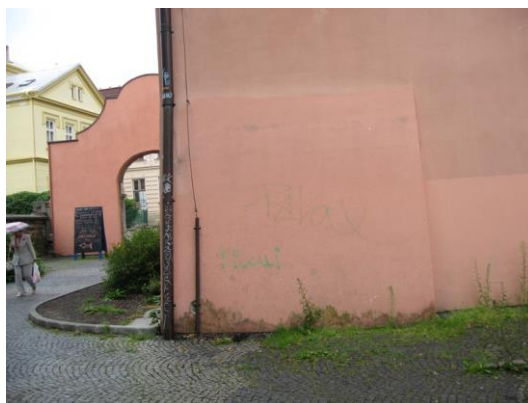
Fotografie 5.1.10 : Rozšíření zdiva v patě historického objektu a jeho znečištění
