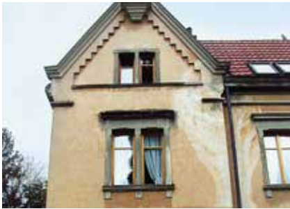
Fehlerhafte Putzflächen Fixit 462
