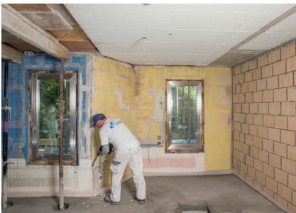
Unterschiedlich starke Ausbrüche Fixit 462
