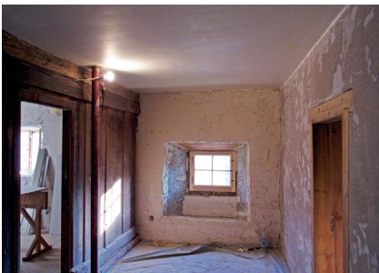
Unterschiedlich starke Ausbrüche Fixit 125 / Fixit 632 Rapid
