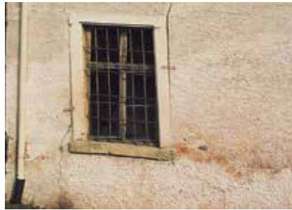
Unschöne Putzflächen Fixit 460 / Fixit 461 / Fixit 462
