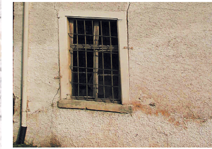
Unschöne Putzflächen Fixit 460 / Fixit 461 / Fixit 462
