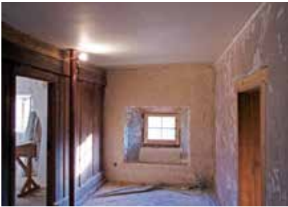
Unterschiedlich starke Ausbrüche Fixit 125 / Fixit 632 Rapid
