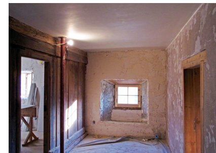
Unterschiedlich starke Ausbrüche Fixit 125 / Fixit 632 Rapid
