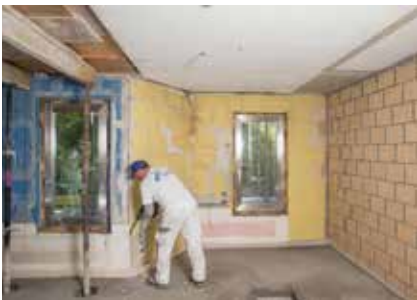
Unterschiedlich starke Ausbrüche Fixit 462
