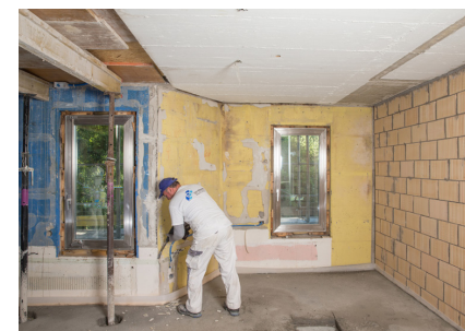
Unterschiedlich starke Ausbrüche Fixit 462
