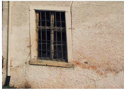
Unschöne Putzflächen Fixit 460 / Fixit 461 / Fixit 462
