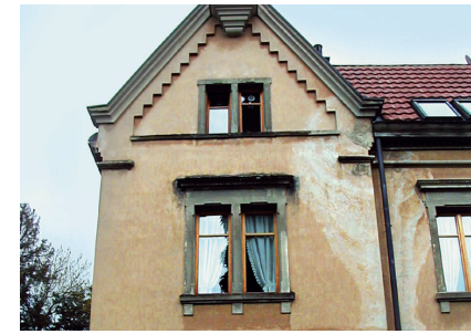
Fehlerhafte Putzflächen Fixit 462
