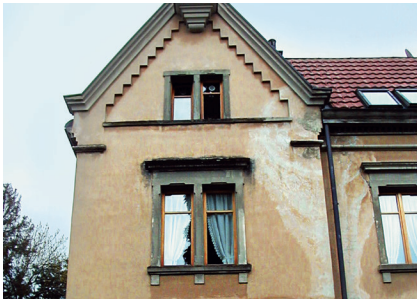
Fehlerhafte Putzflächen Fixit 462
