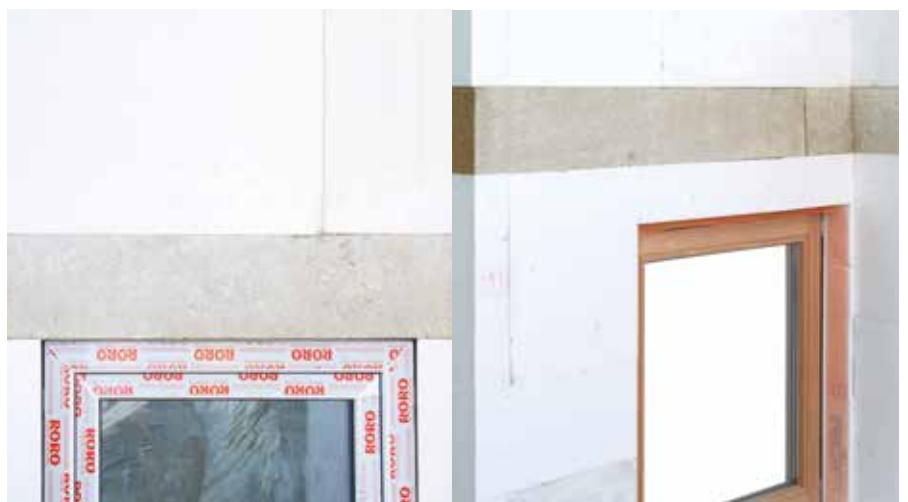
Protupožarna barijera iznad otvora
