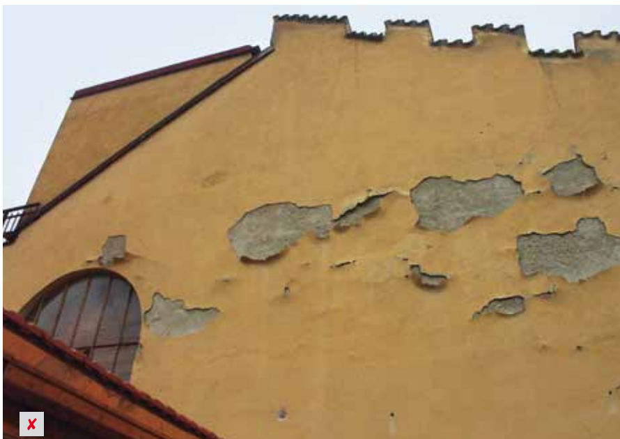
Резултати след ремонта с твърде плътни или корави шпакловки
