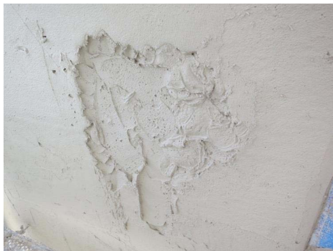
Bild 19: Anfängliche Probleme beim Auftragen des Aerogel-Dämmputzes FIXIT 222 hinsichtlich seiner Haftung auf dem Untergrund (Feld A1).
