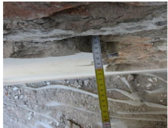
Bild 13: Freigelegtes Loch in der Fassade im unteren Bereich des Feldes A2, mit einer Tiefe von ca. 25 cm.
