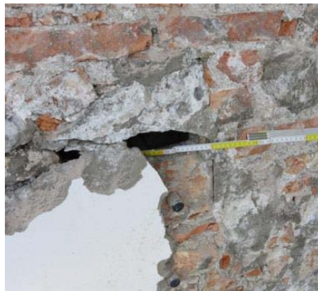
Bild 12: Freigelegtes Loch in der Fassade im unteren Bereich des Feldes A2 nach Abnahme des hohlliegenden Bestandputzes.
