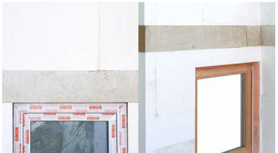
Protupožarna barijera iznad otvora
