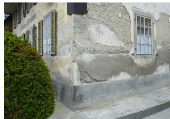
Ausblühungen oberhalb Zementputz
