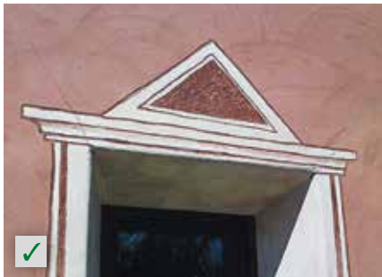
Fissures dans l'enduit RÖFIX Renostar®, RÖFIX Renoplus®
