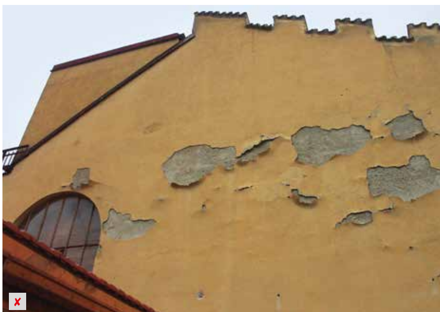
Résultats d'une restauration avec des enduits de ragréage trop imperméables ou trop rigides
