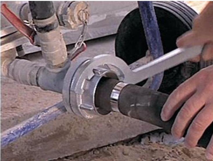
Fot. 8 Końcówki węży przepompowujących materiał należy zawsze precyzyjnie dokręcić specjalnym kluczem, co zapewni prawidłową i bezpieczną pracę.
