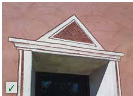
Fessure nell'intonaco RÖFIX Renostar®, RÖFIX Renoplus®
