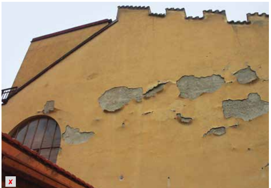
Risultati di restauro con rasanti troppo impermeabili o troppo rigidi
