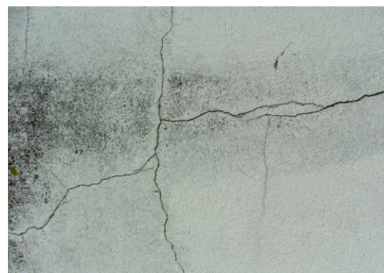
Fissure de retrait sur la couche solidifiée
