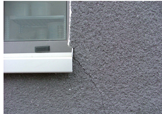
Fissures aux angles des ouvertures
