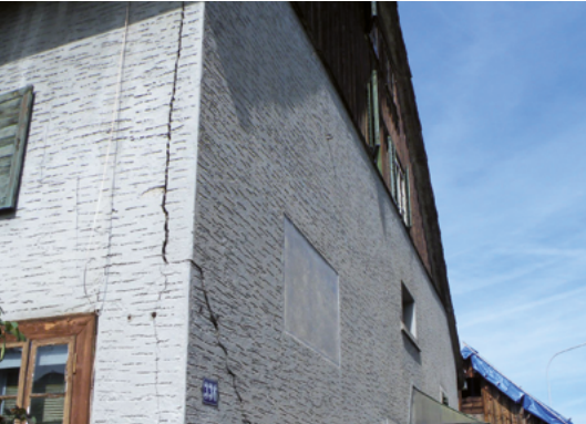
Fissures dans un élément de construction
