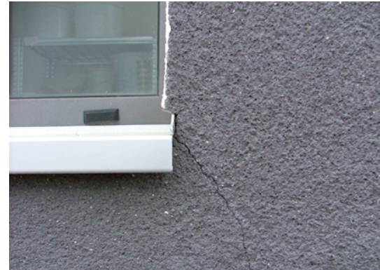
Fissures aux angles des ouvertures
