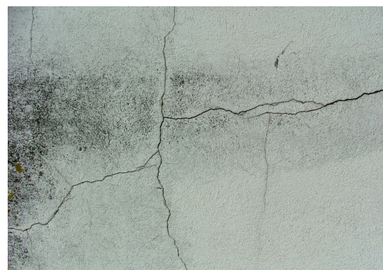
Fissure de retrait sur la couche solidifiée
