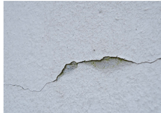
Décollement / fissuration du crépi
