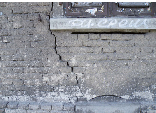
Fissures dans un élément de construction
