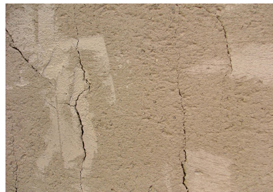
Fissure de retrait sur la couche fraîche
