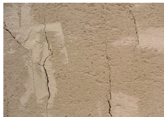
Fissure de retrait sur la couche fraîche
