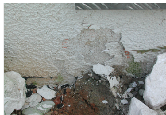
Par l'effet du gel, l'humidité dans la zone du socle cause des dégâts dans le crépi
