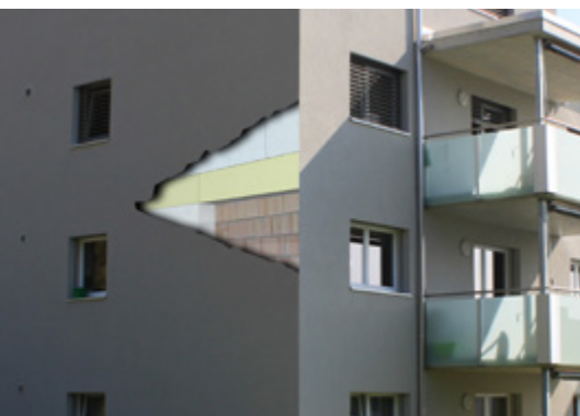
Barrière de protection incendie
