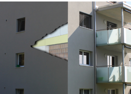
Barrière de protection incendie
