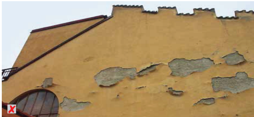
Risultati di restauro con rasanti troppo impermeabili o troppo rigidi
