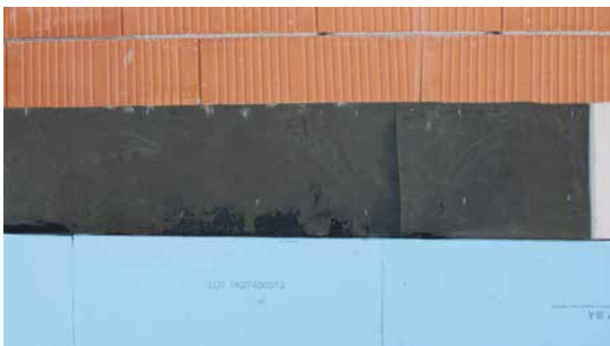
Izolacijske plošče za podzidek so prilepljene na bitumenske role z RÖFIX 1K Plus Hladnim bitumenskim lepilom
