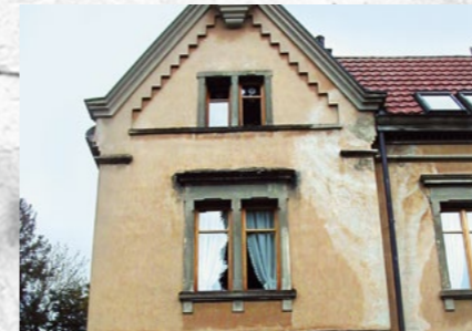
Fehlerhafte Oberputzflächen 250 RENOPLUS
