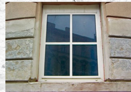
Unterschiedlich starke Ausbrüche 250 RENOPLUS
