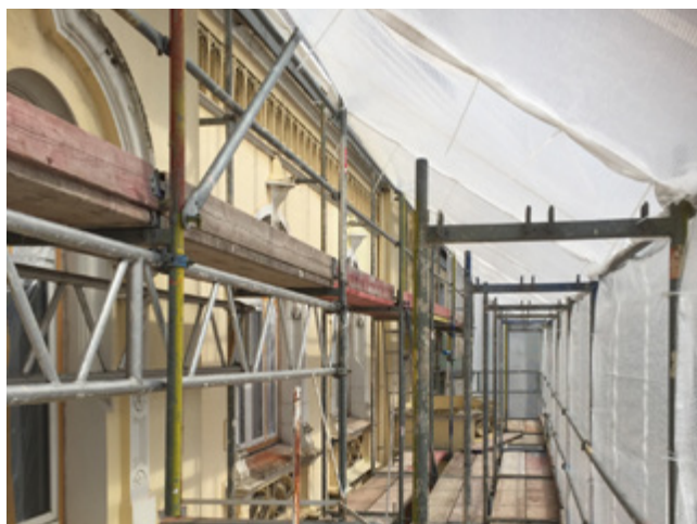
Gerüst mit Regenschutzdach
