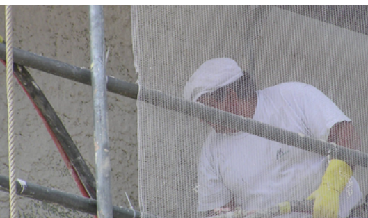
Einsatz von Fassadennetzen zum Schutz vor direkter Sonneneinstrahlung
