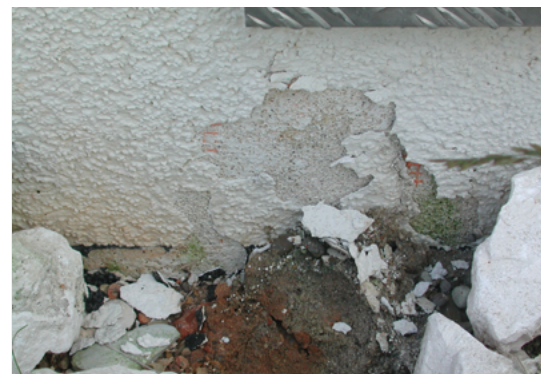
Nässe im Sockelbereich führt bei Frost-Einwirkung zu Putzschäden
