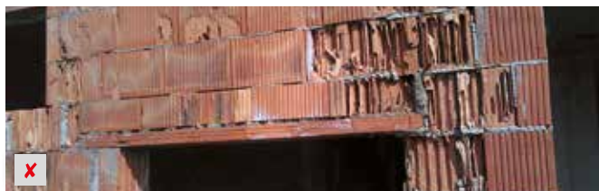
Oštećeni zid od opeke
