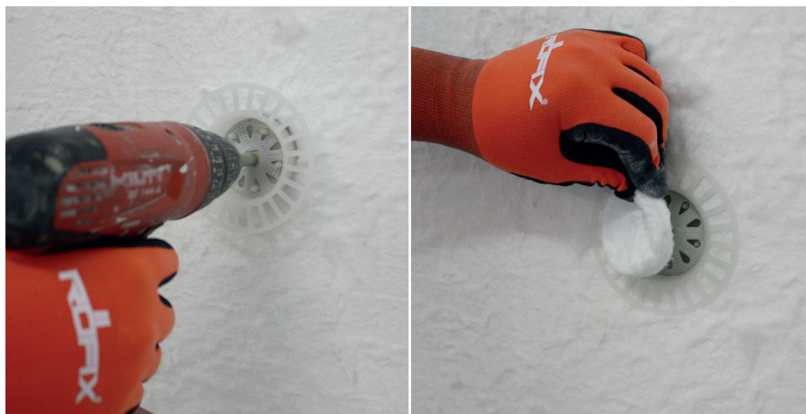
Pri debelinah izolacije več kot 60 mm vgradimo Sidrno podložko prekrijemo z izrezano rondelo. sidra z ugrezno podložko
