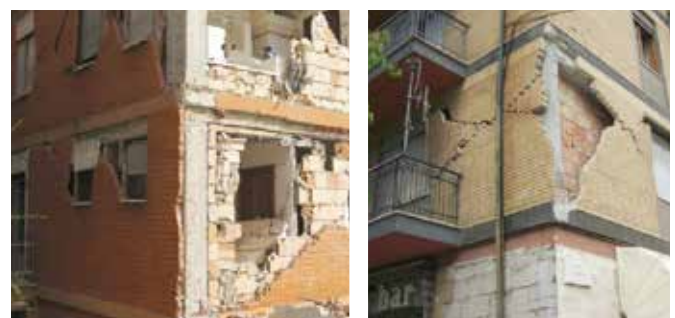
Oštećenje i razdvajanje slojeva fasade
