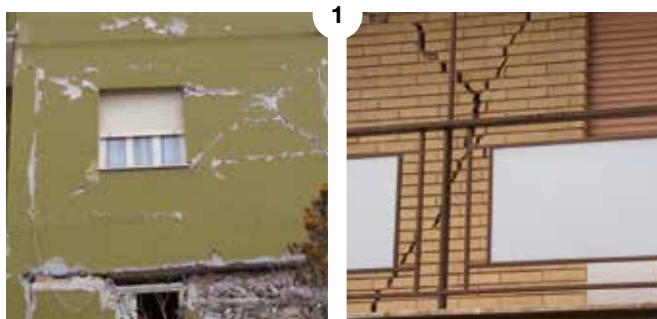
Dijagonalne pukotine u nenosivom zidu unutar armirano-betonskih okvirnih konstrukcija
