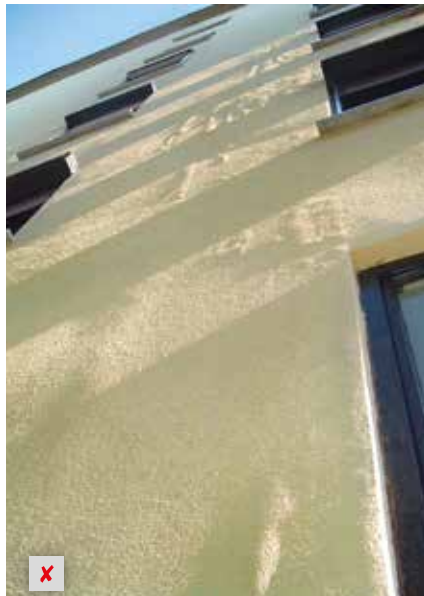
Izbokline na fasadah
