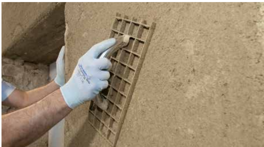
Strganje osnovnega ometa RÖFIX CalceClima® Ambiente s posebno zobčasto gladilko RÖFIX Schleifwunder
