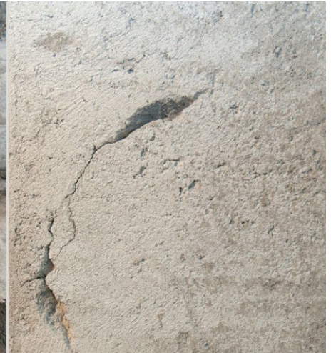
Fehlstellen in Altputz
