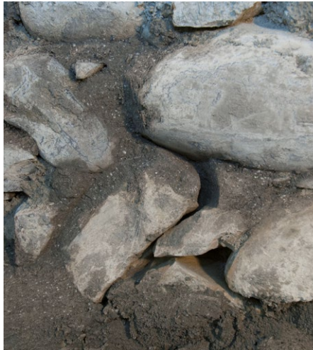
Fehlstellen in Natursteinmauerwerk
