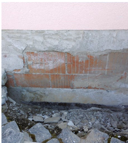
Sockelschaden durch Staunässe
