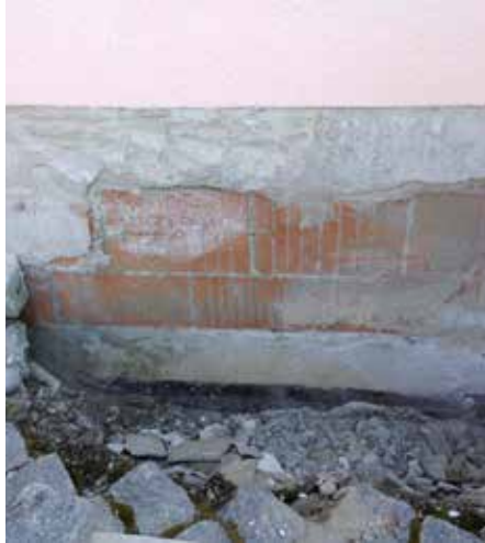
Sockelschaden durch Staunässe
