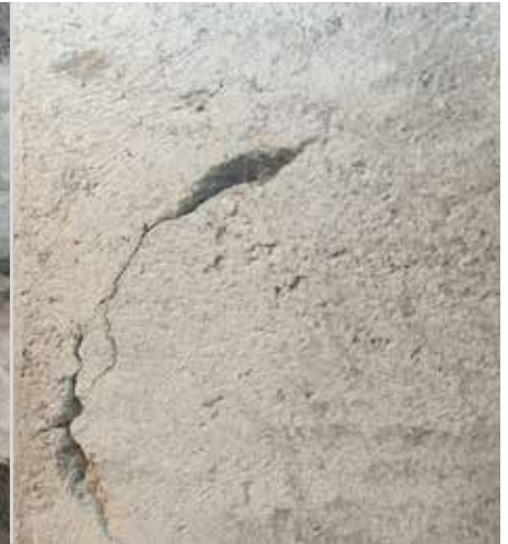
Fehlstellen in Altputz
