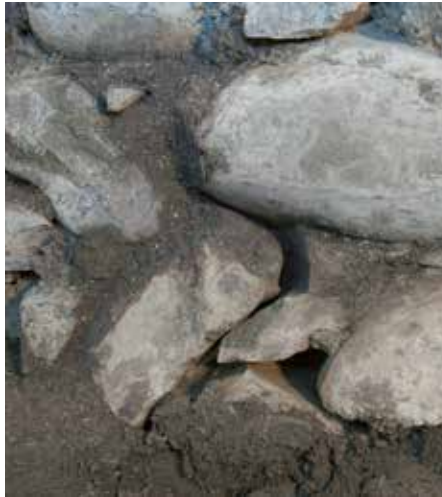
Fehlstellen in Natursteinmauerwerk
