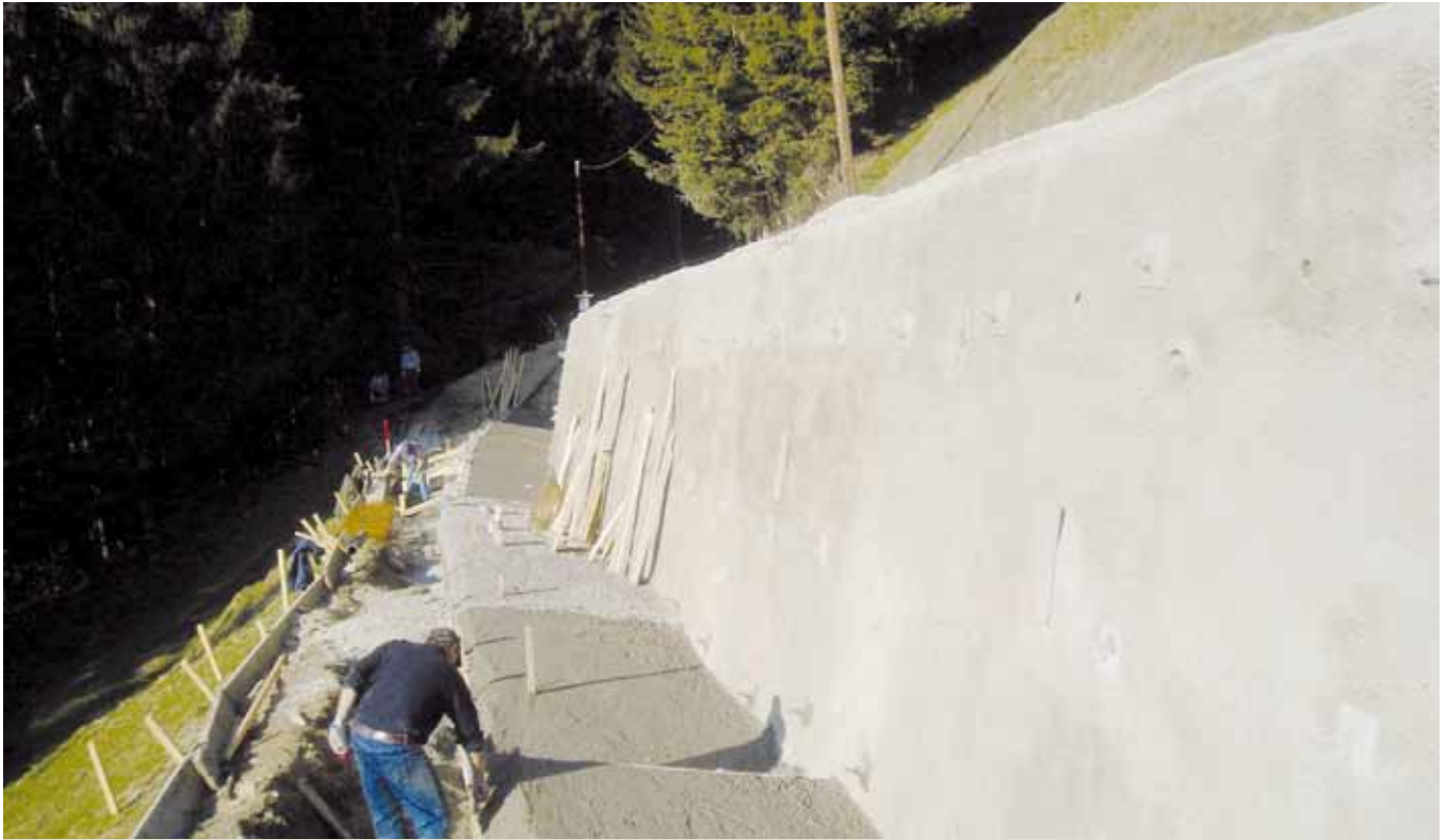
Progetto/luogo: consolidamento di pendio a Kitzbuhel (AT) Gruppo prodotti/prodotto: Calcestruzzo a spruzzo/RÖFIX CreteoShot RG8 S; Calcestruzzo per iniezione/RÖFIX Creteoinject 995
