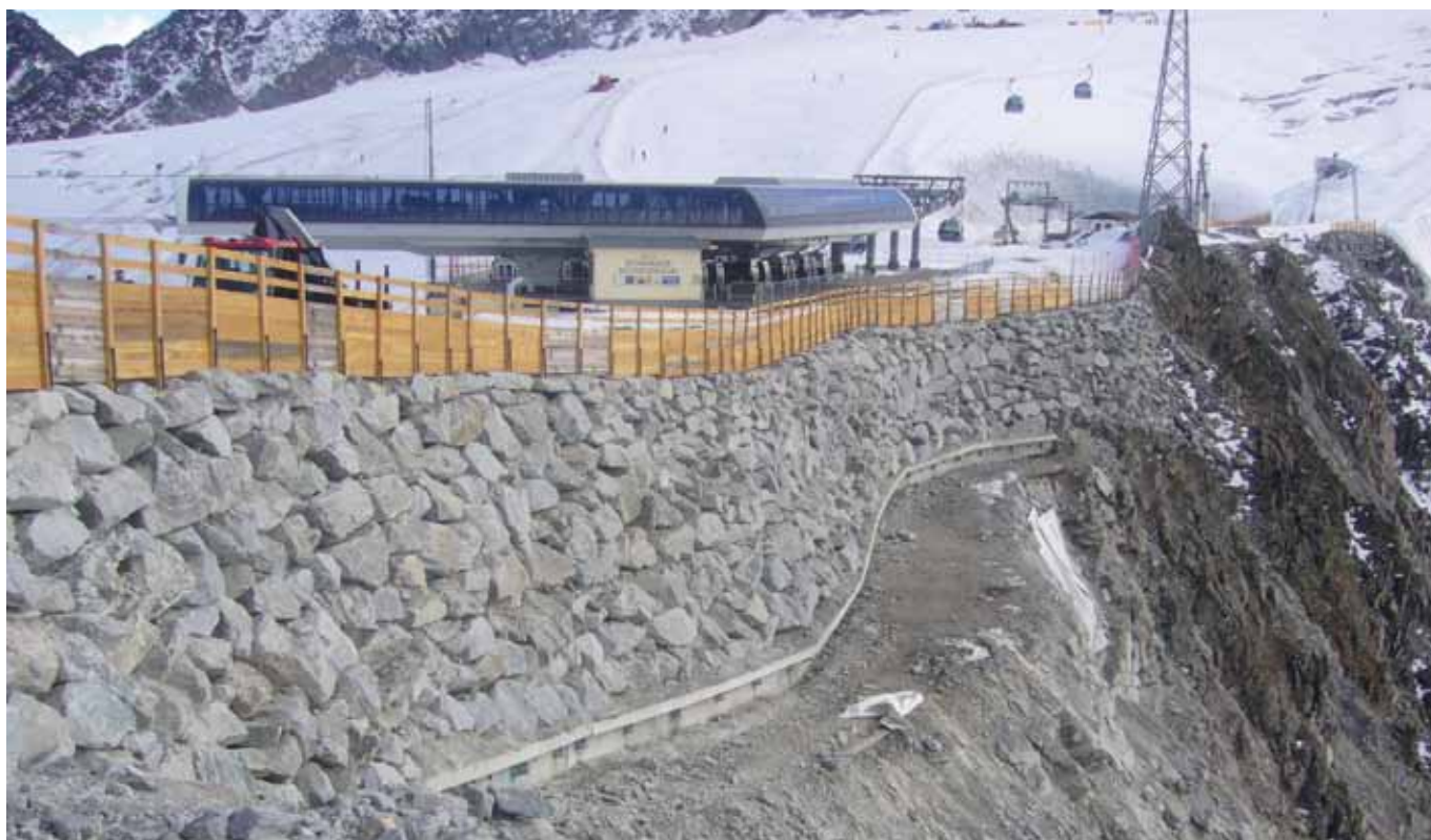
Progetto/luogo: messa in sicurezza di un versante a Solden (AT) Gruppo prodotti/prodotto: Calcestruzzo standard/RÖFIX CreteoStandard 990 B30; Calcestruzzo per iniezione/RÖFIX CreteoInject 995
