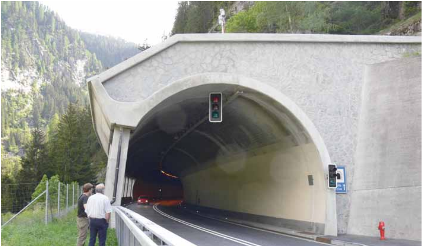
Progetto/luogo: strada di San Bernardino (CH) Gruppo prodotti/prodotto: Calcestruzzo per riparazioni/RÖFIX CreteoRepair CC 194 M
