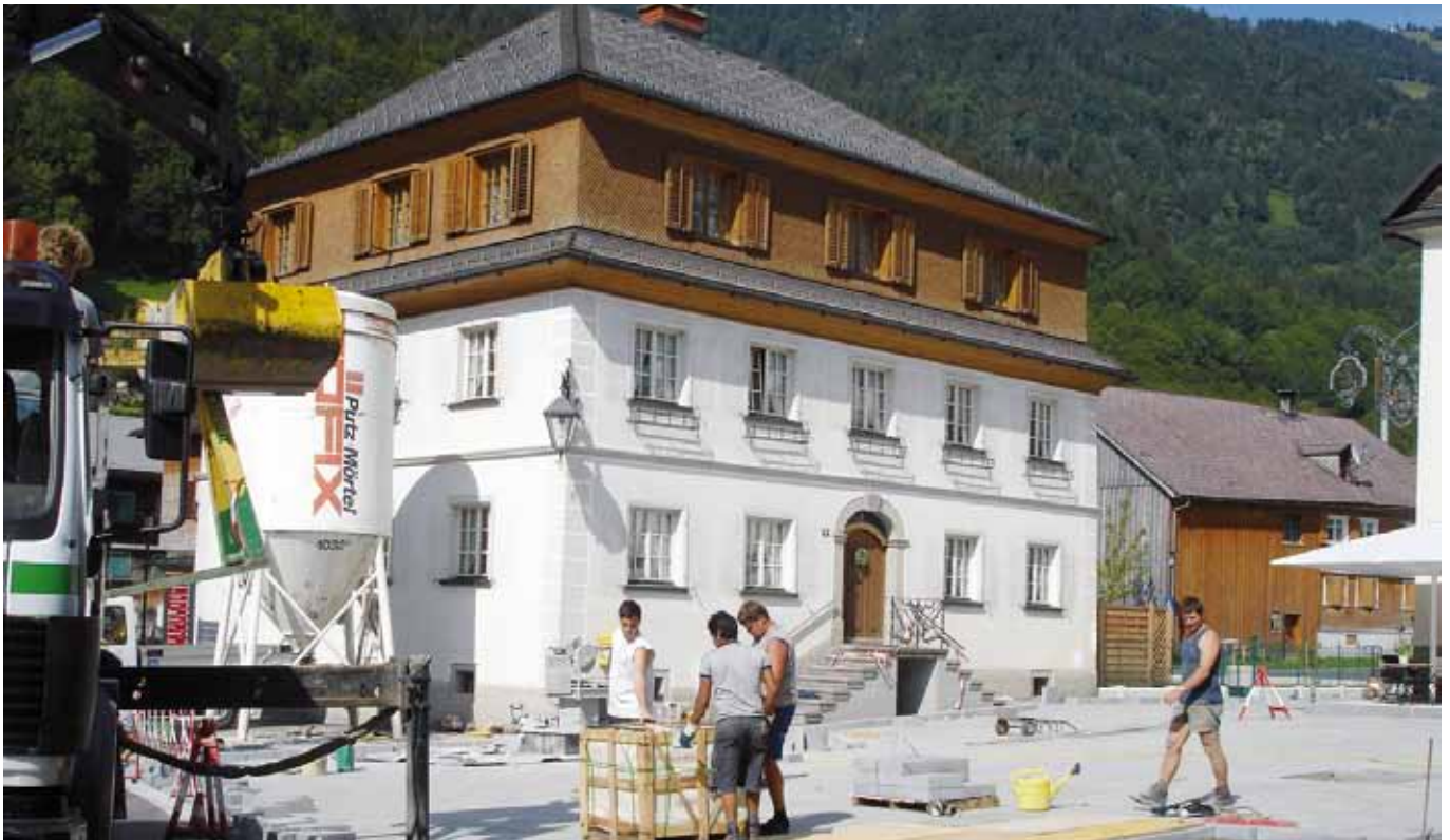
Progetto/luogo: lavori di ristrutturazione a Bezau (AT) Gruppo prodotti/prodotto: Sistemi di pavimentazione per esterno/RÖFIX CreteoGala CC 633
