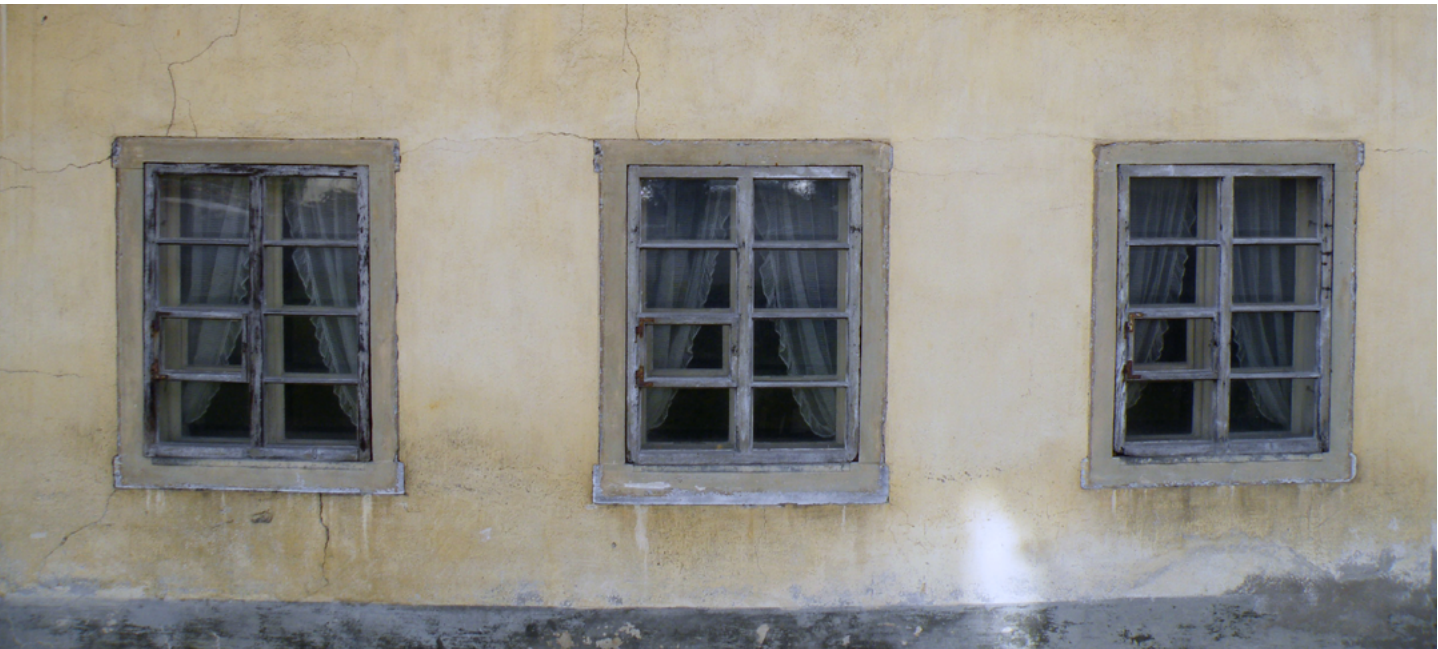
Fassade mit Rissen
