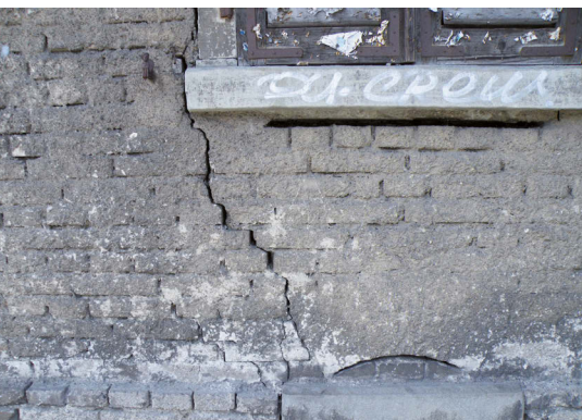
Risse im Bauteil
