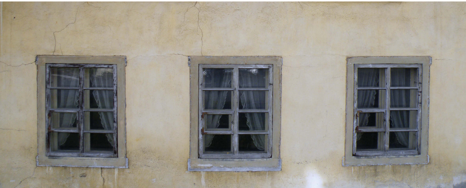
Fassade mit Rissen
