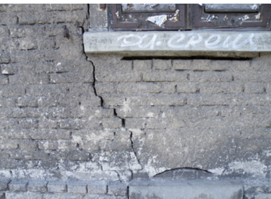
Risse im Bauteil
