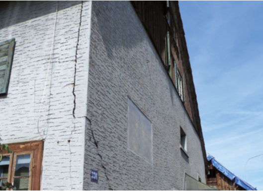
Risse im Bauteil
