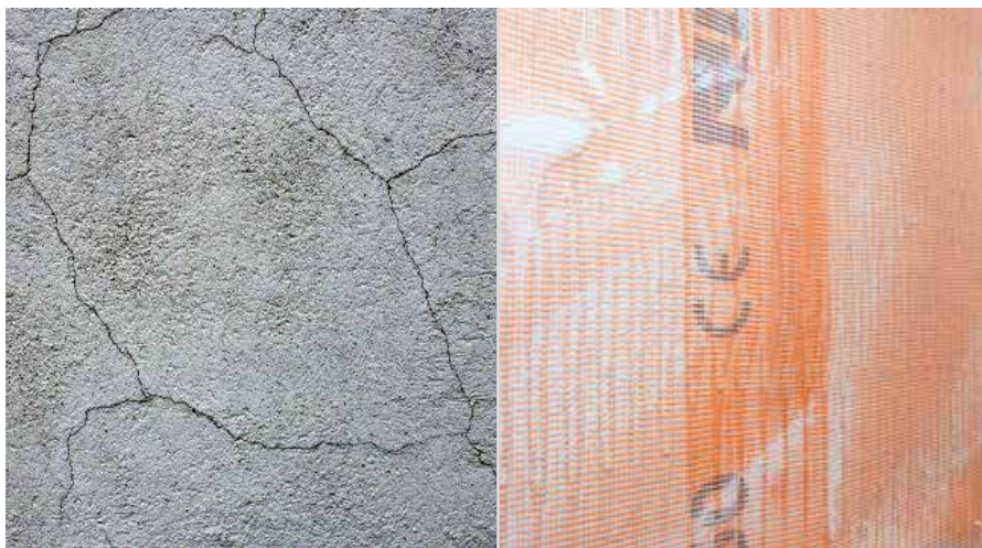
Pukotina nastala puzanjem | RÖFIX Renoplus® Malter za renoviranje i izravnjavanje (armiranje)
