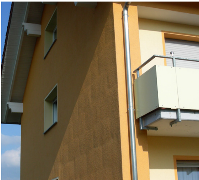
Lumière rasante sur la façade avec panneaux isolants. Les panneaux sont visibles, mais doivent être acceptés selon la norme SIA 243 "Isolation thermique extérieure crépie".
