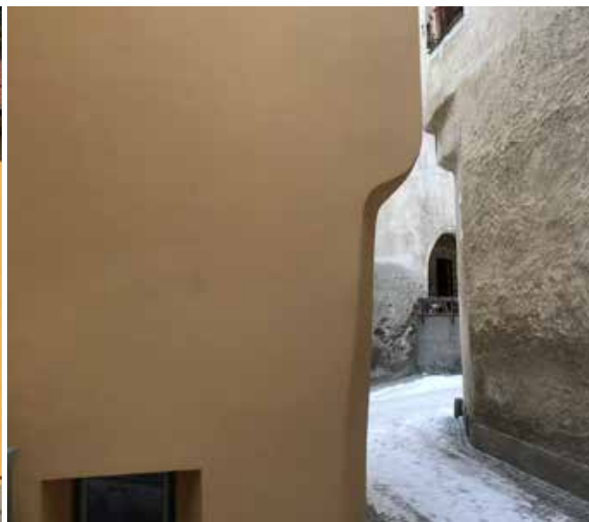
Ici, la façade avec un enduit isolant aérogel raconte une histoire compréhensible.
