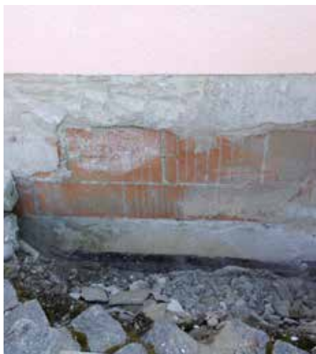
Oštećenja podnožja zbog nakupljanja vlage
