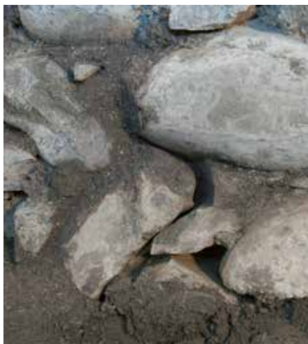
Praznine u zidu od prirodnog kamena
