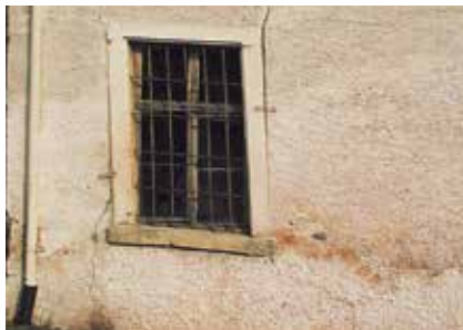
Surfaces d'enduit inesthétiques Fixit 460 / Fixit 461 / Fixit 462
