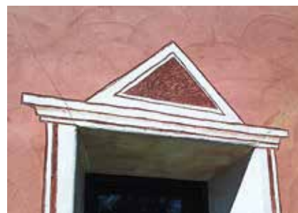
Fissures d'enduit Fixit 460 / Fixit 461
