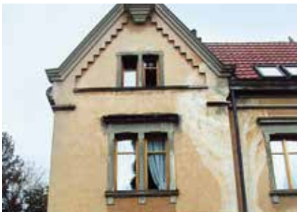
Surfaces d'enduit imparfaites Fixit 462
