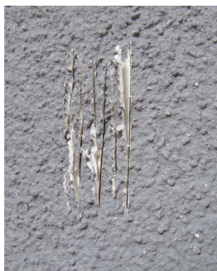
Coupe parallèle/couche insuffisamment porteuse
