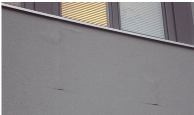
Fissures et gonflements du crépi dans le joint du panneau
