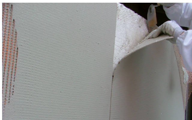
Détachement de l'enduit des panneaux EPS
