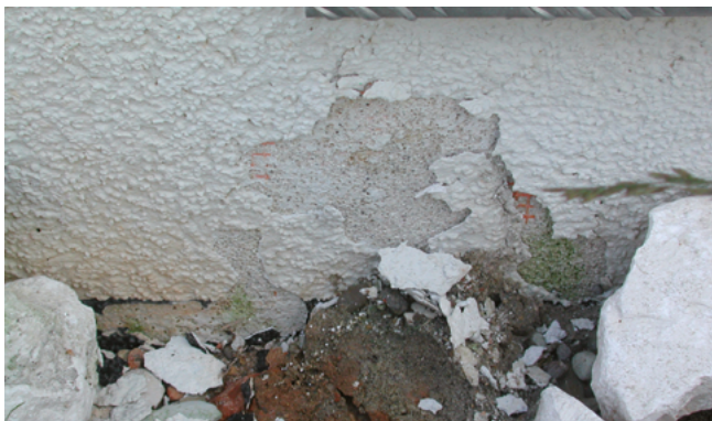
Zone du soubassement
