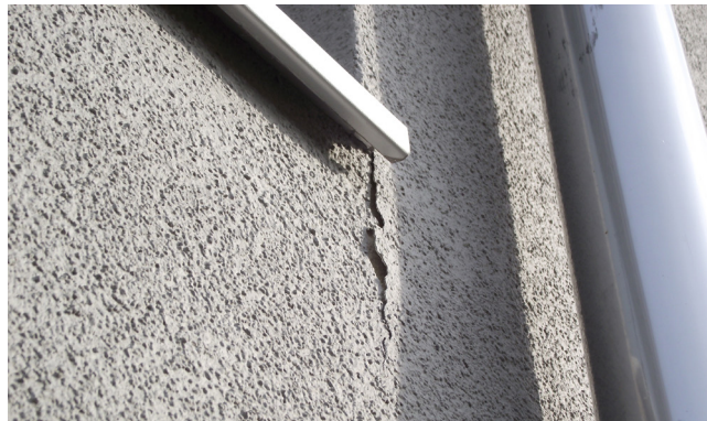
Gonflements et formation de bulles à grande surface
