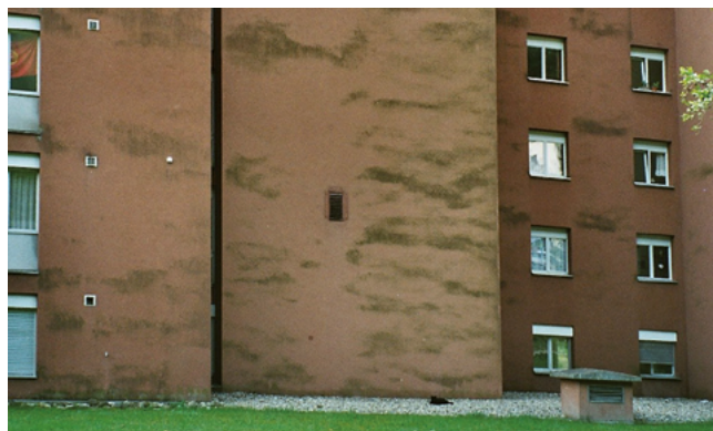
Façades pénétrées d'humidité avec algues
