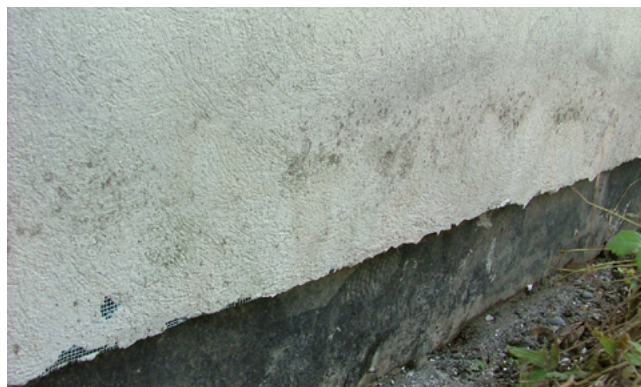
Zone du soubassement
