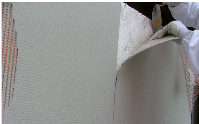
Détachement de l'enduit des panneaux EPS
