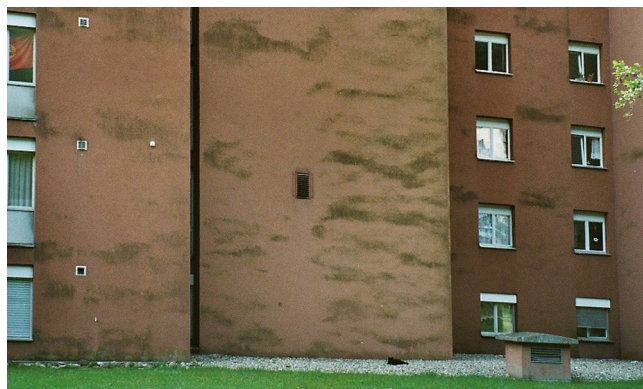
Façades pénétrées d'humidité avec algues
