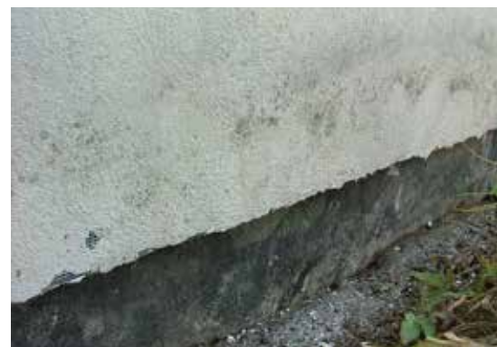
Zone du soubassement
