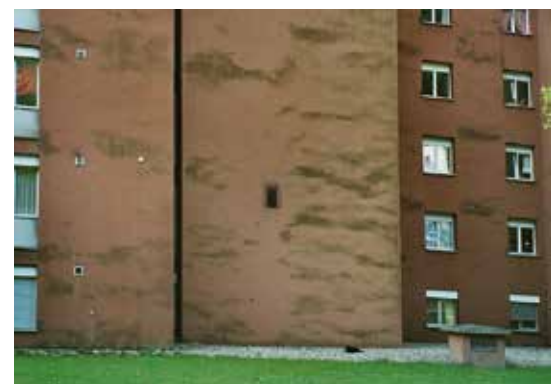
Façades pénétrées d'humidité avec algues
