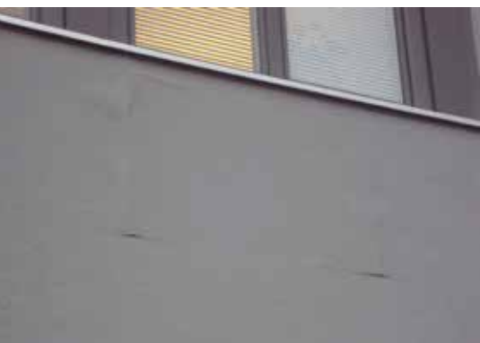
Fissures et gonflements du crépi dans le joint du panneau
