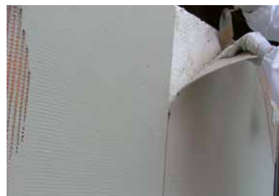
Détachement de l'enduit des panneaux EPS
