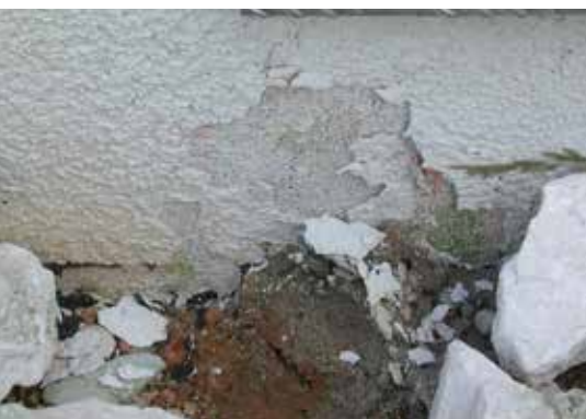
Zone du soubassement
