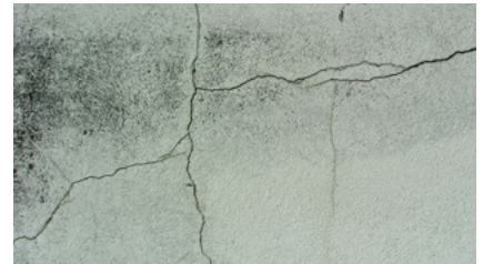
grosse Schwindrisse im abgeblundenen Zustand
