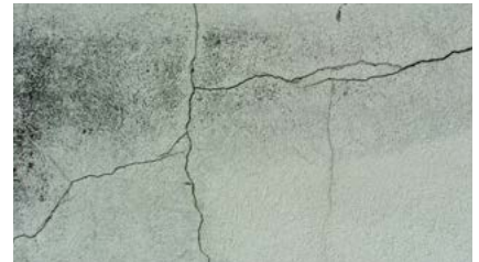
grosse Schwindrisse im abgebuendeten Zustand
