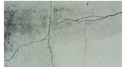
grosse Schwindrisse im abgeordneten Zustand
