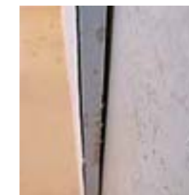
Plattenanierung mit Hohlräumen
