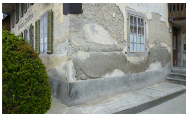
Efflorescences au-dessus de l'enduit ciment
