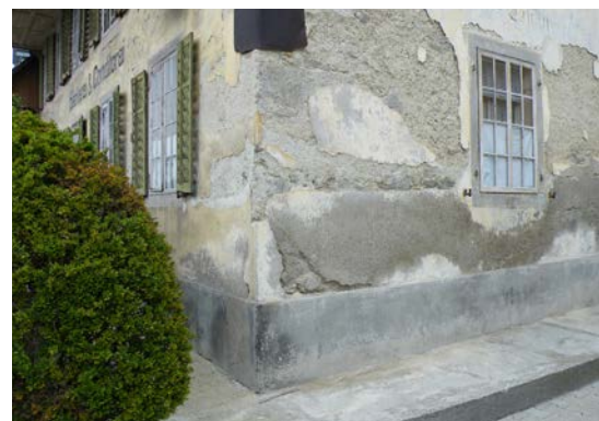
Efflorescences au-dessus de l'enduit ciment
