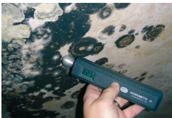
Bild 1 und 2: Typische Schimmelschäden
