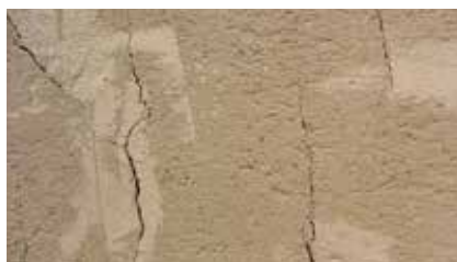
Fissures de retrait sur la couche fraîche
