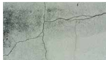
Grandes fissures de retrait sur la couche solidifiée
