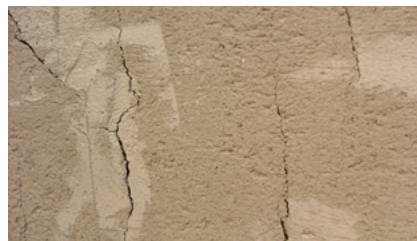
Fissures de retrait sur la couche fraîche
