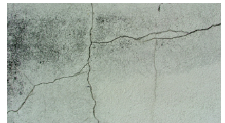
Grandes fissures de retrait sur la couche solidifiée
