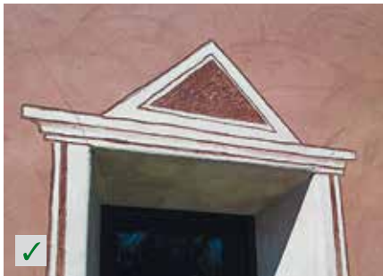
Pukotine RÖFIX Renostar® RÖFIX Renoplus®
