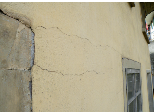
Fessure dei giunti della muratura
