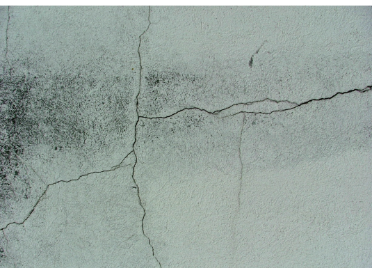
Fessure dovute a ritiro sullo strato di intonaco indurito
