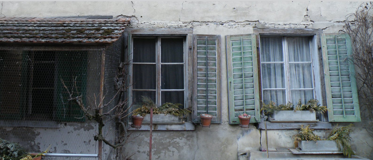
Facciata con fessure
