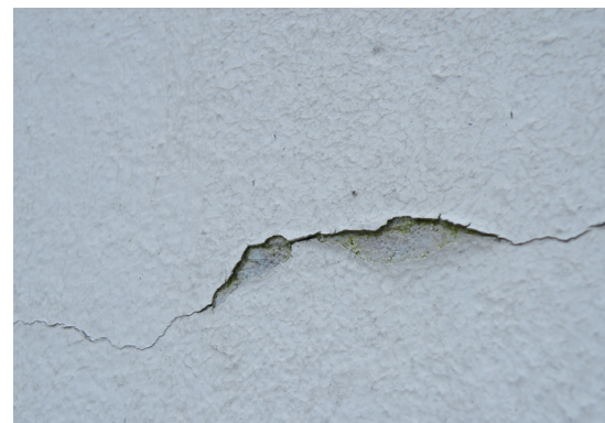
Distacco con fessurazione dell'intonaco di finitura
