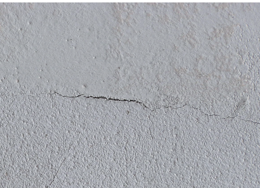
Fessure dovute a cedimento
