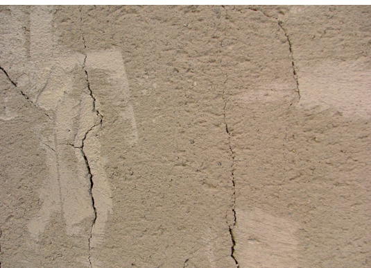
Fessure dovute a ritiro sullo strato di intonaco fresco
