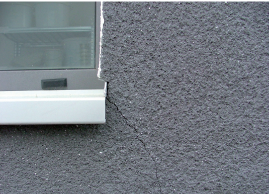
Fessure in corrispondenza degli angoli delle aperture
