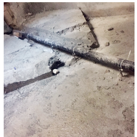
Alter, stark saugender Beton: PE-Folie oder mehrtägiges benetzen mit Wasser
