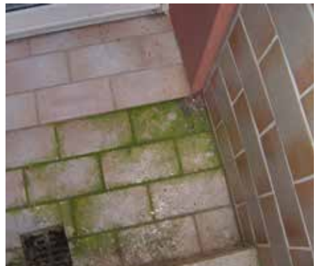
Bild 4: Algenbewuchs im Bereich des Ablaufs eines Kellerabganges
