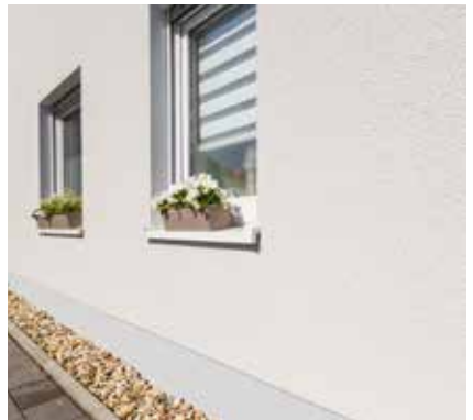
Bild 5.2: Algenfreier Spritzwasserbereich einer Fassade
