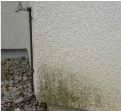
Bild 5.1: Algenbewuchs im Spritzwasserbereich einer Fassade
