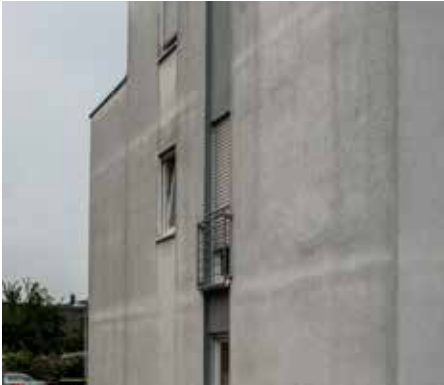
Bild 1: Pilzbewuchs auf einer Fassade
